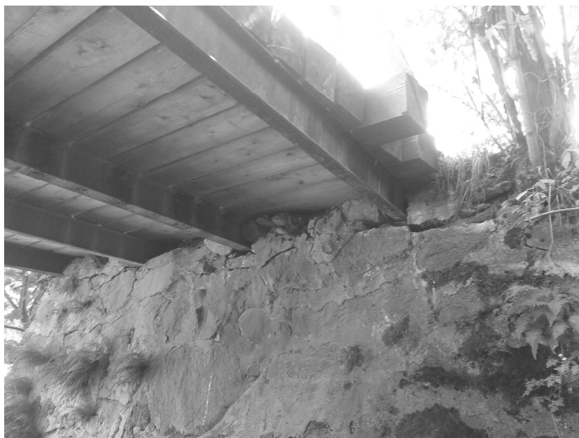
Fot. 5 Przyczółek południowy. Ubytki konstrukcji murowej w górnej strefie powodują brak stabilności kształtowników IN200.
