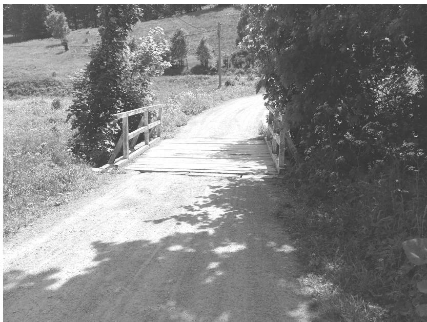
Fot. 1 Widok ogólny mostu. Uszkodzenia nawierzchni drewnianej pomostu, zły stan balustrad drewnianych
