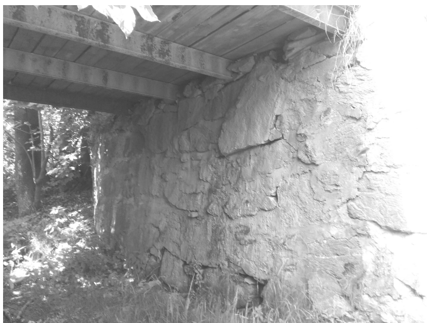
Fot. 4 Przyczółek północny. Ubytki materiału w strefie przynurtowej. Uszkodzenia w części górnej. Widoczny pomost z belek drewnianych na dwuteownikach IN200. Widoczna korozja stali.
