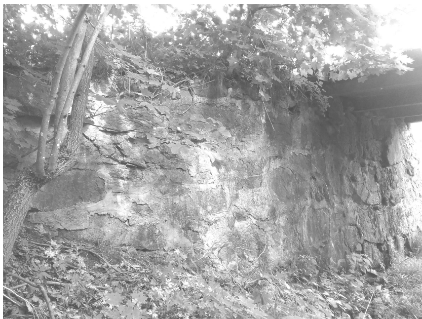
Fot. 7 Kamienny mur oporowy koryta potoku od strony północnej. Ubytki i spękania konstrukcji. Silna wegetacja roślin.
