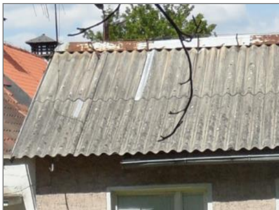
Fot. 1 Płyty azbestowo-cementowe faliste
