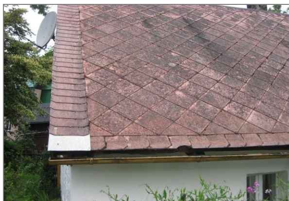
Fot. 2 Płyty azbestowo-cementowe płaskie
